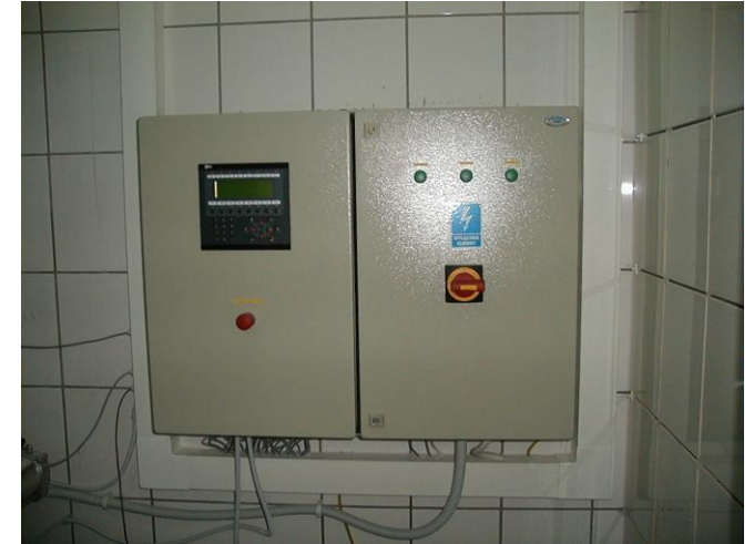
Szafa elektryczna sterująca
