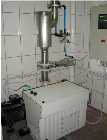
Zespół pompa separator
