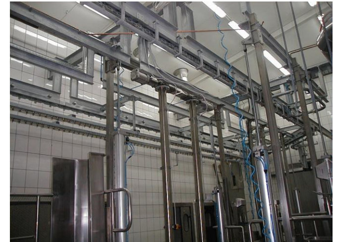
System rurociągów i zasuw
